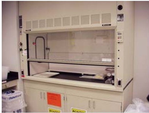
Figura 1: Campana de humos típica para laboratorio cerrado
